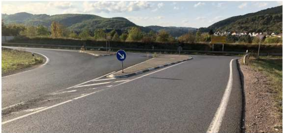
Abb. 5: Knotenpunkt B41 / K40 (K2) aus Richtung Dicksbach, bzw. Knotenpunkt K1
